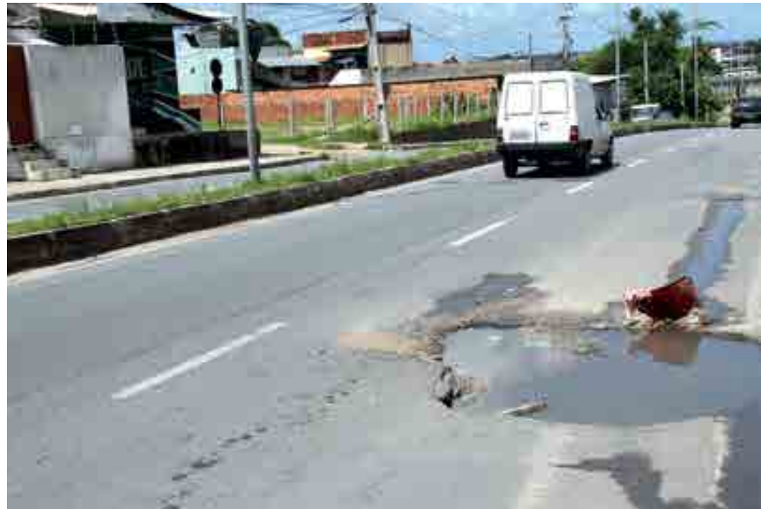
Cair dentro de uma vala como esta é risco certo de acidente, sem contar os danos causados no carro, se ele passar
